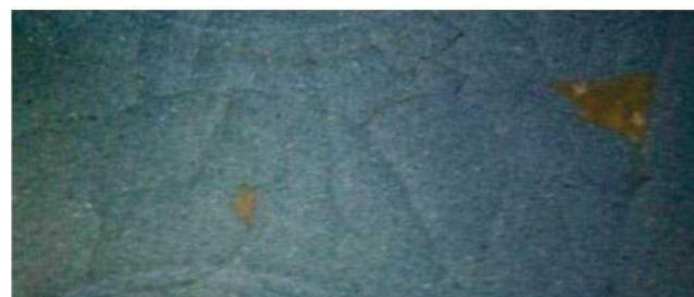
Figura 5.- Fragmentación y levantado de un suelo vinílico por efecto del LN 2 .
