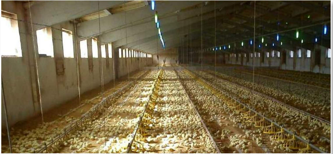
Instalación mixta producción/experimentación en la que se han generado cuatro espacios dividiendo la nave longitudinal y transversalmente
