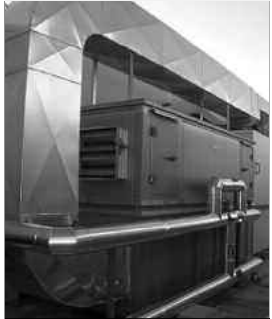
Figura 2. Estación de climatización típica de un animalario
